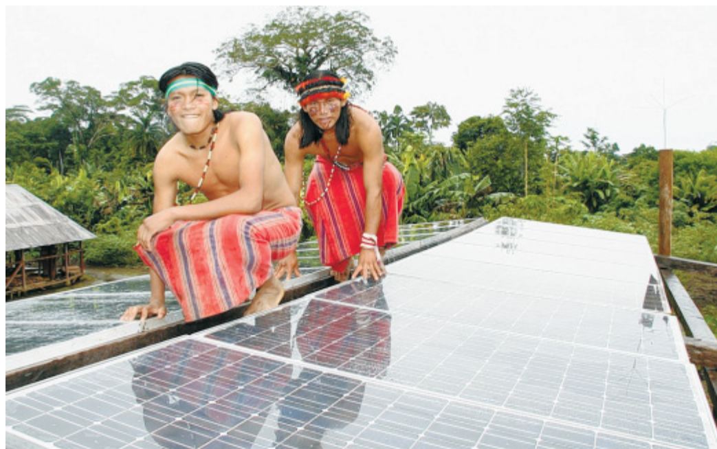
Energiequelle: Strom erzeugen Photovoltaik-Anlagen für das abgelegene Dorf, damit die Bewohner stets mit Wasser und Licht versorgt sind.
